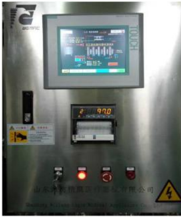
注射用水配电柜
