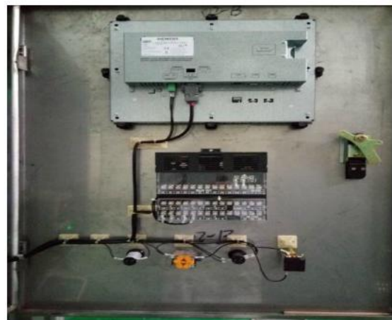
注射用水配电柜（b）
