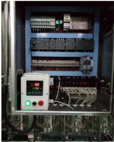
注射用水配电柜（a）
