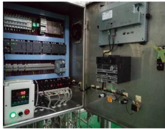
注射用水配电柜（总电源）
