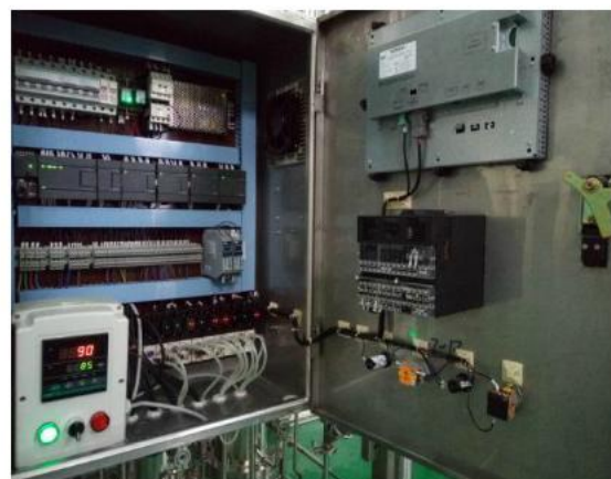
注射用水配电柜（总电源）
