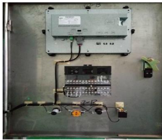
注射用水配电柜 (b)
