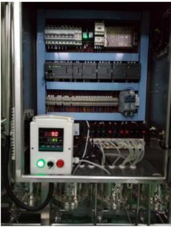
注射用水配电柜 (a)
